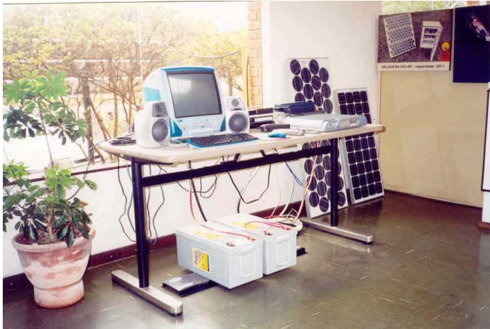
Foto 9: Sistema fotovoltaico nacional, com computador, monitor com placa de TV, vídeo cassete, modem para conexão à Internet via satélite.
