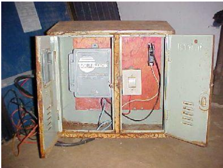
Foto 5 – Paraíba: Equipamento desativado por falta de manutenção
